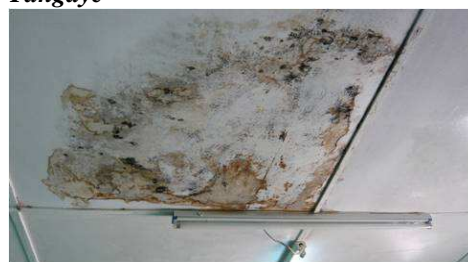
Photo 2. Plafond de la maternité de Tangaye
