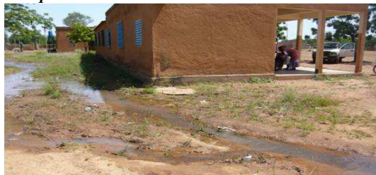
Photo 4. Ecoulement d'eau à l'arrière du poste anti-paludisme
